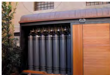
Fragment systemu butlowego w kontenerze zewnętrznym (fot. autor)
