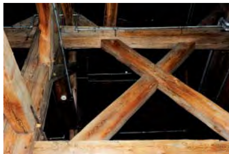
Rurociąg, rurka detekcyjna, dysze w drewnianej dzwonnicy (fot. autor)
