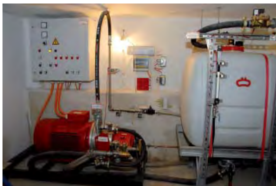
Pompownia ze zbiornikiem (fot. autor)
