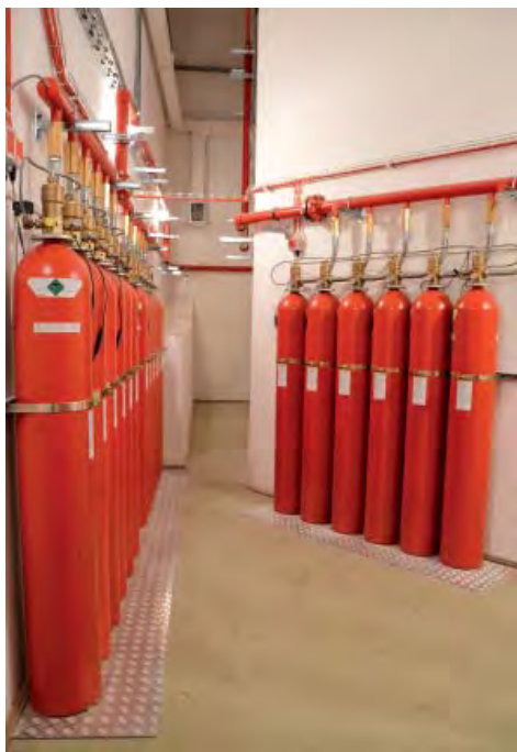
Butle z gazem w instalacji dwustrefowej (fot. autor)
