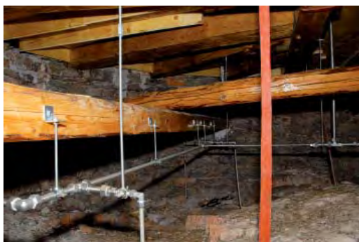
Fragment instalacji rurowej (fot. autor)
