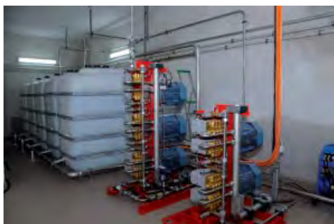
Duży system pompowy (fot. autor)
