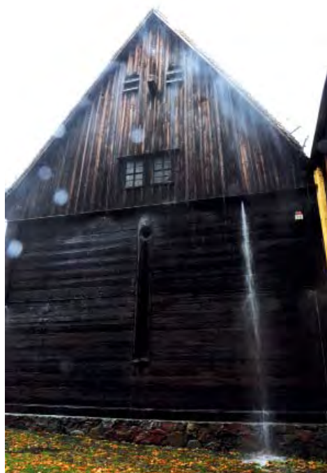
Wpływ wody po urwaniu dyszy (fot. autor)
