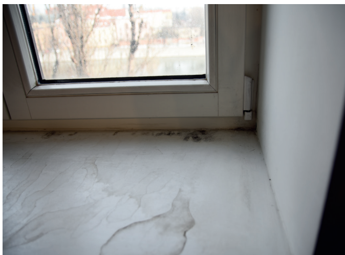
Ryc. 13. Wzrost pleśni na parapecie w sali ekspozycyjnej na poddaszu muzeum; przyczyna: remont z wymianą stolarki okiennej. Fot. M. Dyda
