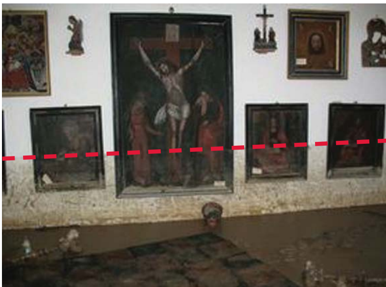
Muzeum parafialne w Binarowej, woj. małopolskie (Przerwana linia oznacza poziom wody podczas powodzi). Fot. Delegatura WUOZ w Nowym Sączu
