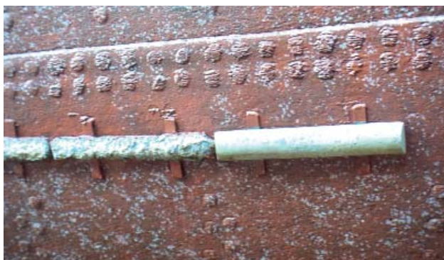
Fot. 7. Nowy i uszkodzony na skutek elektrolizy - protektory cynkowe na poszyci podwodnej części kadłuba Statku-Muzeum „Sołdek” (fot. J. Litwin)
