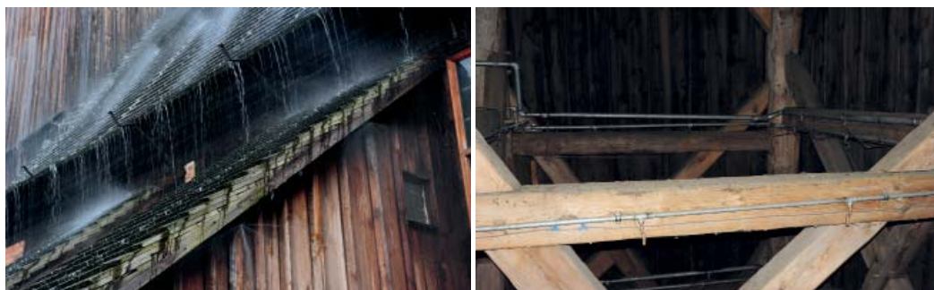
Gaszenie mgłą wodną niskociśnieniową oraz instalacja rurowa z dyszami
